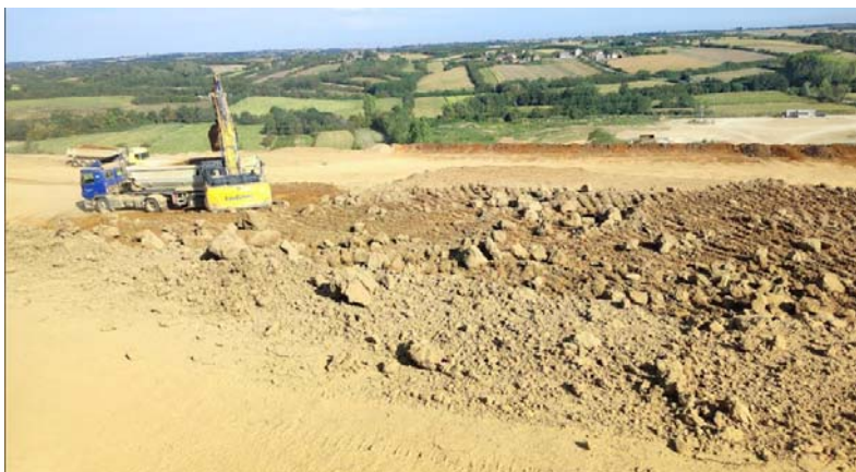
Слика 5: Земљани радови, поглед са дела комплекса поред Улице Јанка Веселиновића (август 2024.)
