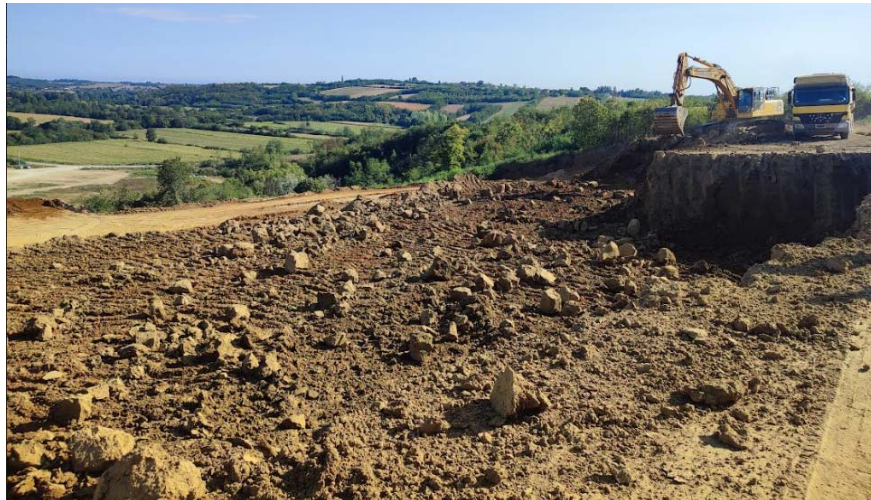
Слика 5: Земљани радови, поглед са дела комплекса поред Улице Јанка Веселиновића (август 2024.)
